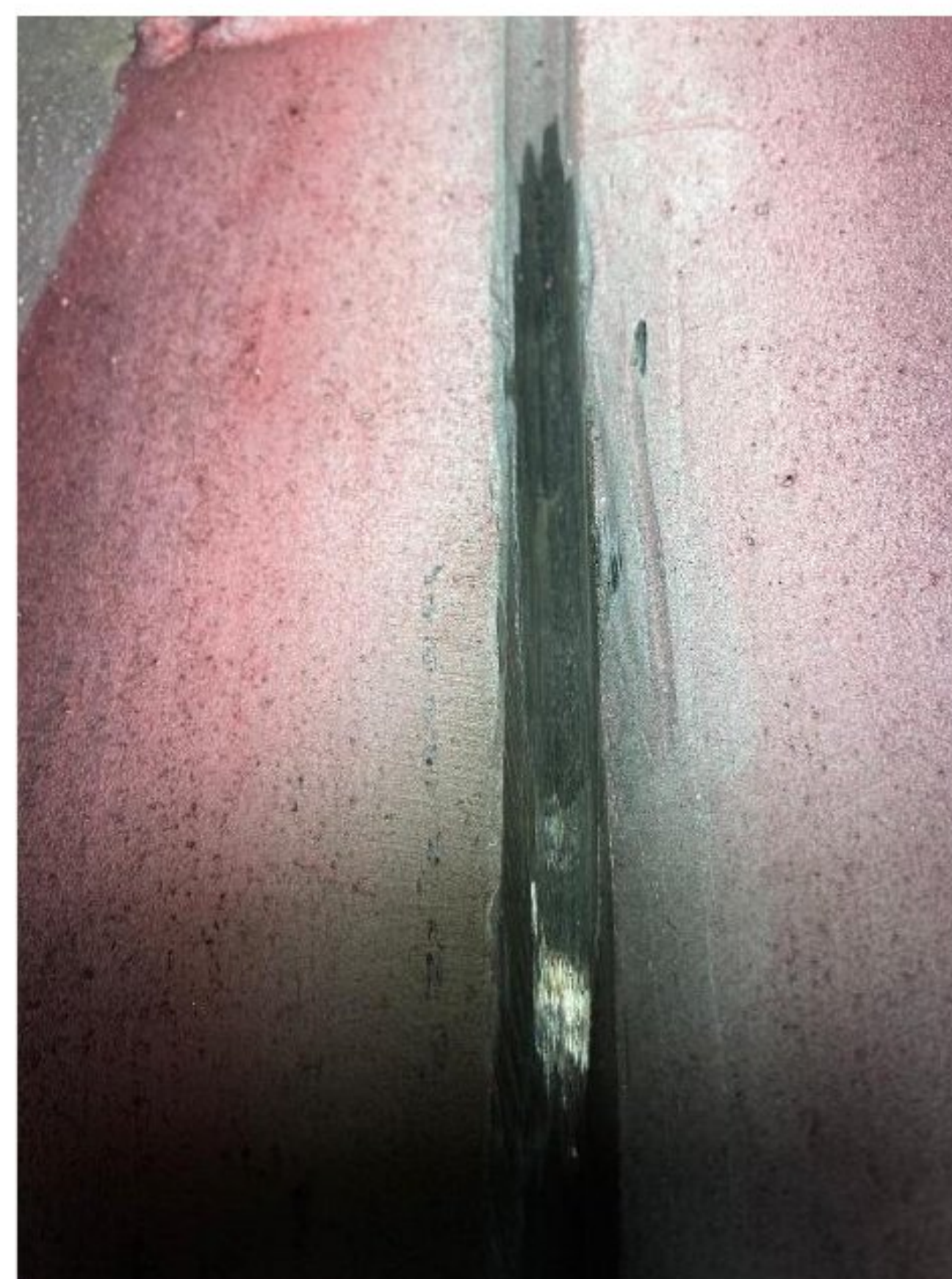
Slika 42. b) Uklanjanje nedostatka
