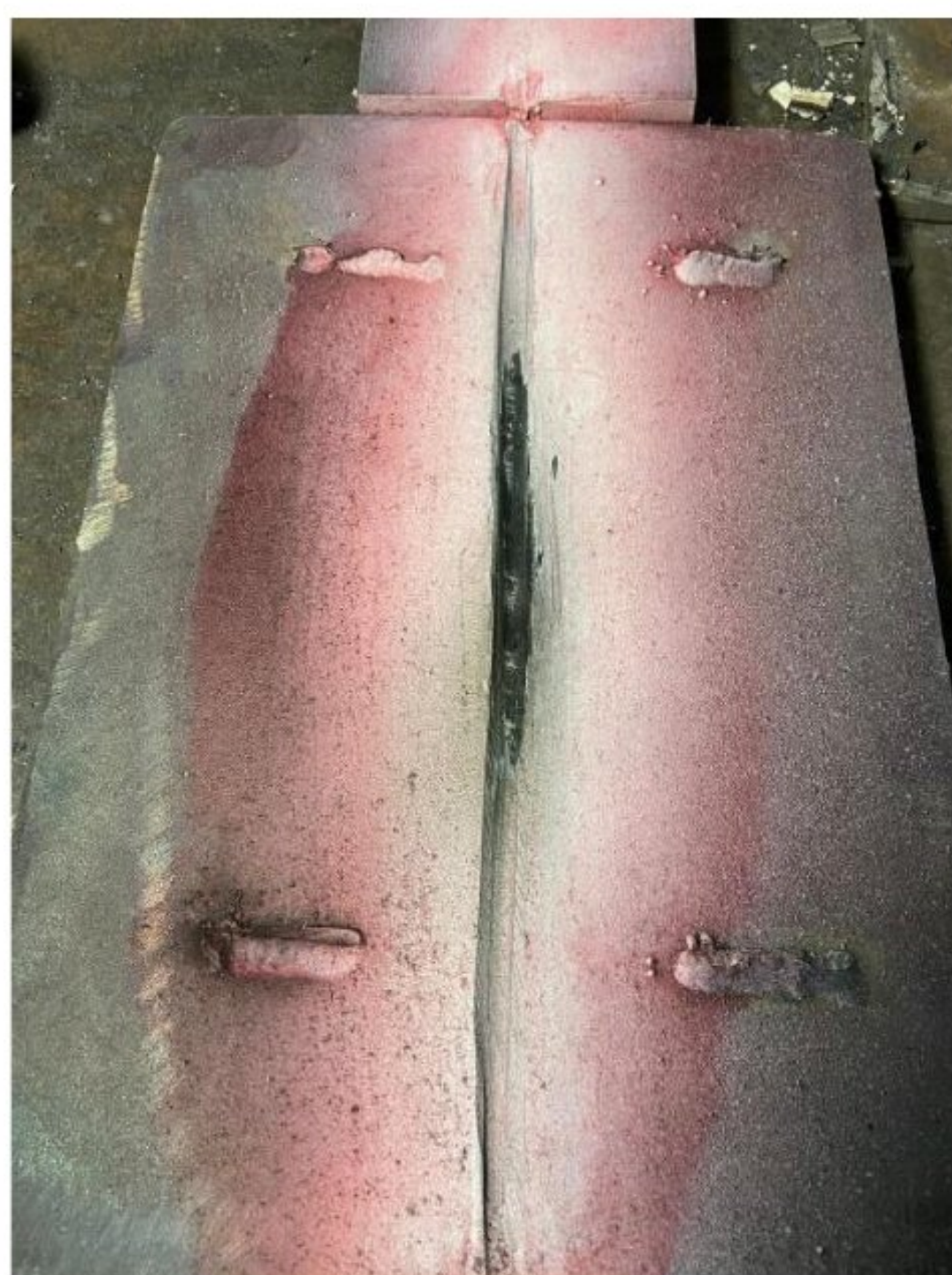
Slika 42. a) Uklanjanje nedostatka
