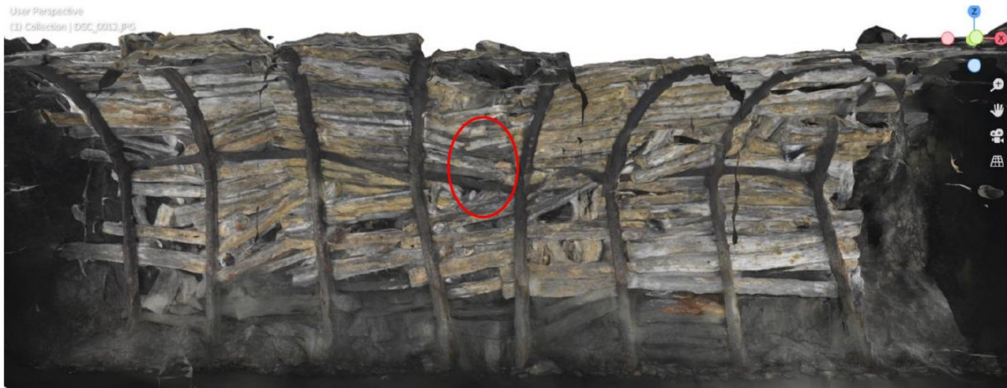
Slika 7. Prikaz dela podgrade na kojem se vidi oslabljena zona.
