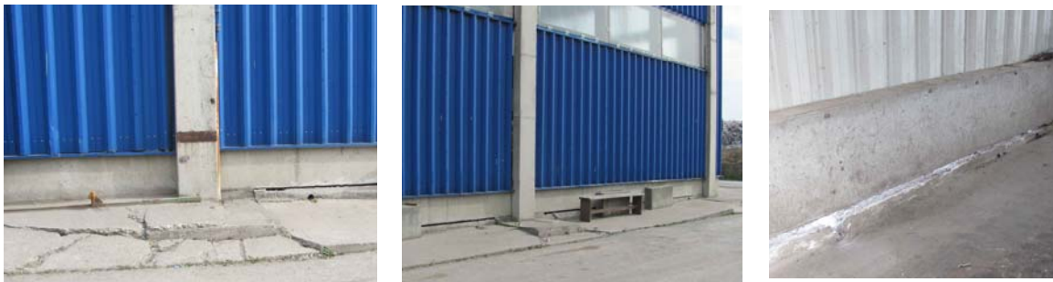
Slika 9.15. Vidljive deformacije na hali usled sleganja komunalnog otpada (snim. 2010 god.)
