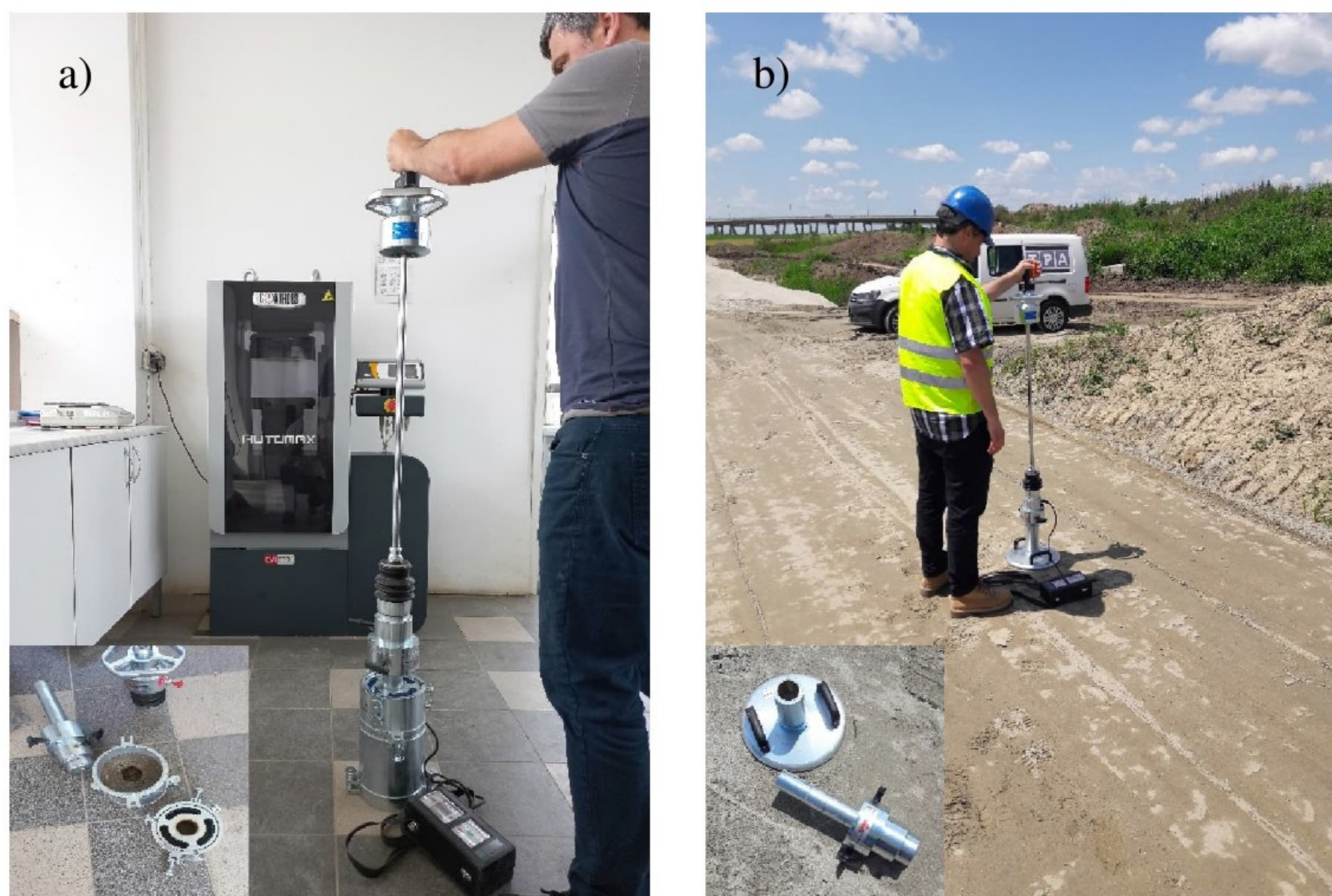
Slika 3.18. Dinamičko CBR_d ispitivanje, korišćenje uređaja sa padajućim tegom LWD za izazivanje definisanog udarnog opterećenja na CBR_d klip a) CBR_{dl} – Laboratorijsko ispitivanje b) CBR_{dt} – „In situ“ ispitivanje
