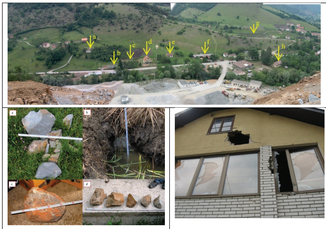
Slika 5.4 – Pogled na oštećene objekte sa etaže kamenoloma, razleteli komadi odminirane mase pronađeni na terenu i detalj oštećenja na objektu
